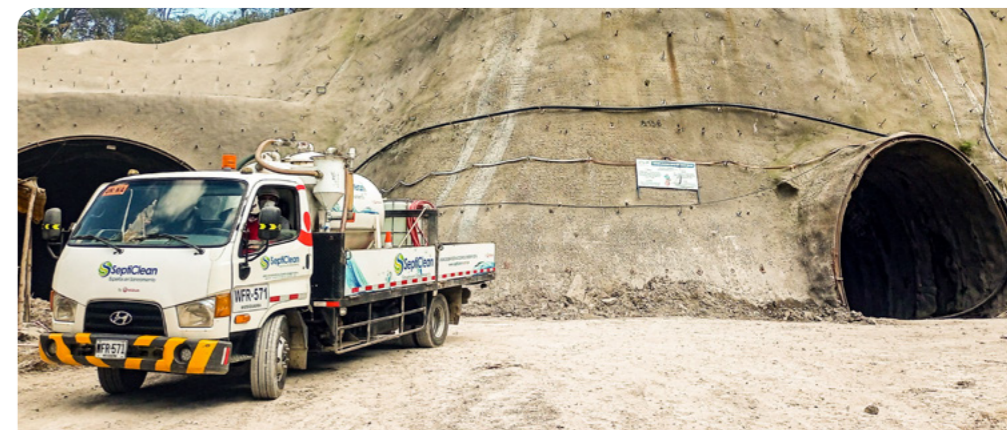
► Túnel de Pamplonita Saneamiento portátil y móvil - SEPTICLEAN Pamplonita, Norte de Santander. Colombia
