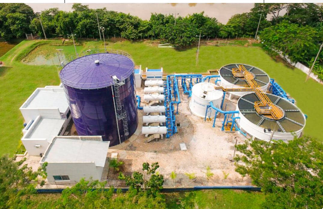
► Planta de tratamiento de agua potable Iguanas Veolia Aguas de Montería, Córdoba. Colombia
