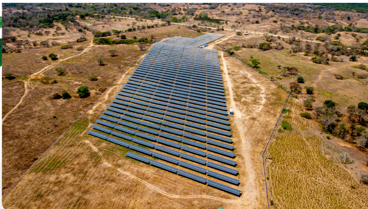
Parque Solar Canal del Dique Arjona, Bolívar. Colombia
